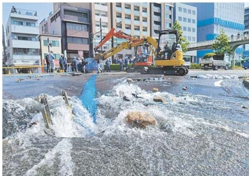
2025年4月に京都市で発生した水道管の漏水で道路にあふれ出た水(京都市下京区・五条高倉交差点付近)
